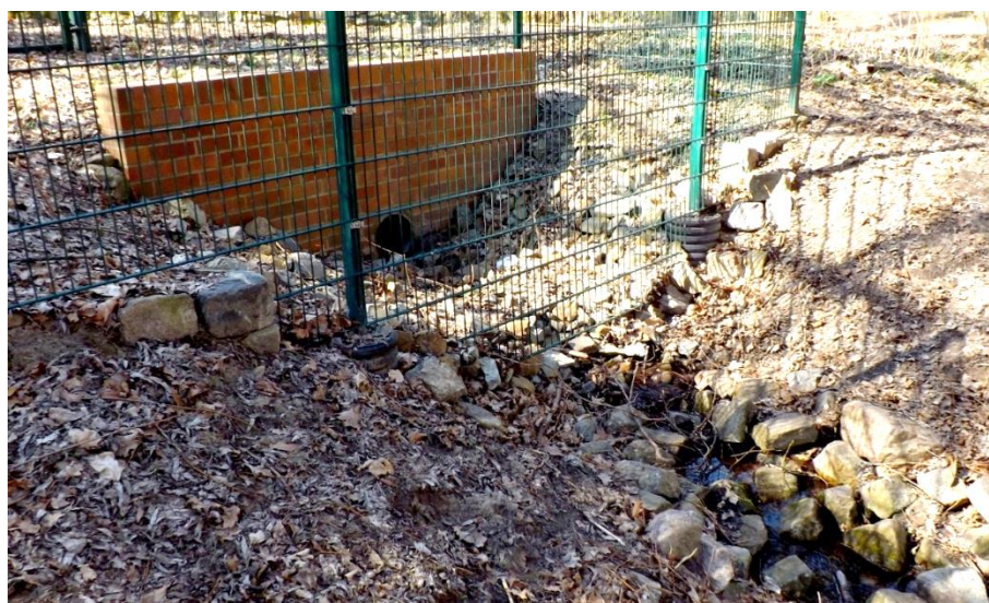
Abb. 3-8: Regenwassereinlauf am Kleinen Rotpfehl.
