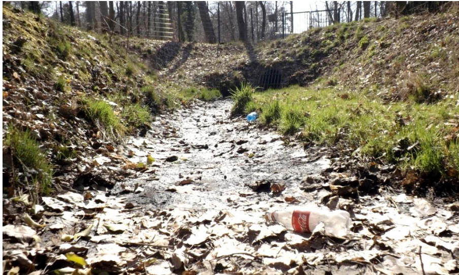
Abb. 3-11: Regenwassereinlauf an der Schönfließler Straße (Großer Rotpfuhl).
