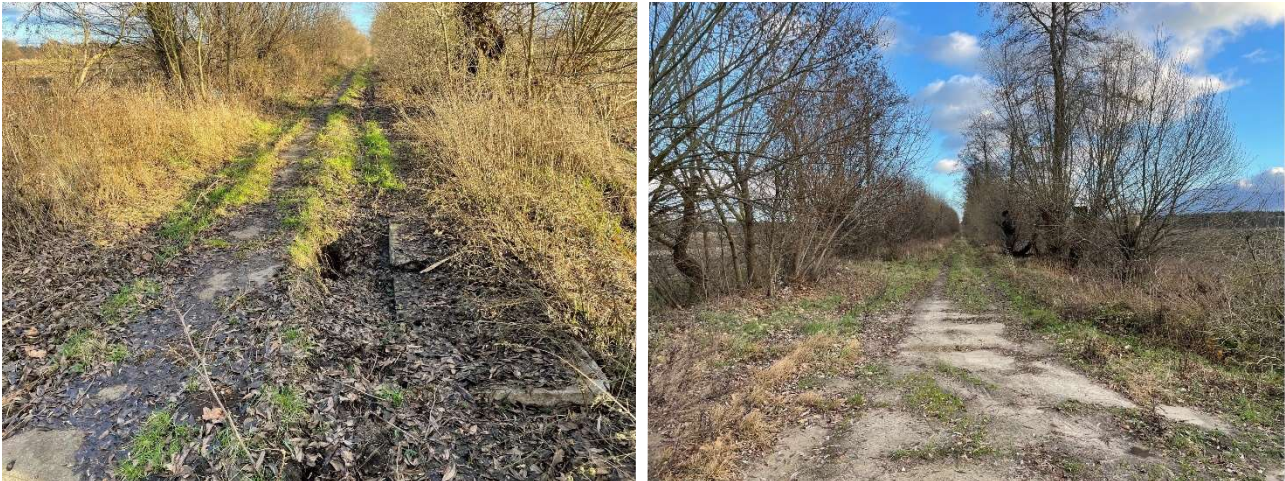
Abbildung 3: Schäden an Spurplattenweg (links), Bestandsbaumreihe (rechts)
